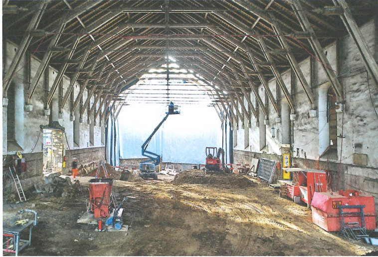
Das Dach wurde bei der Stirnfassade geöffnet, um die Kuben für die Nebenräume zu betonieren. Foto: Luca Zanier
