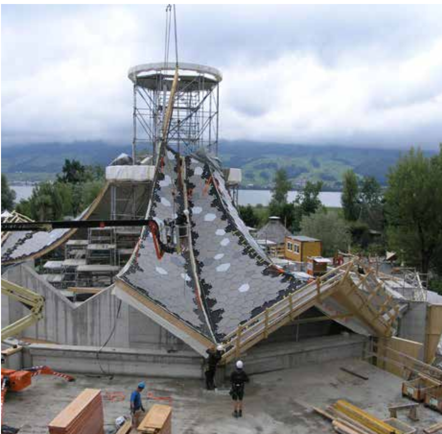
Bild 6: Die gesamte Dachkonstruktion lagert an den zwölf Kehlentiefpunkten auf Nischen im Betonzugring auf. Die Normalkräfte werden über die Kehlbalken in den Betonring eingeleitet bzw. aus den Gratbalken über die Dachrandträger in den Betonring. (Foto: Blumer-Lehmann AG)
